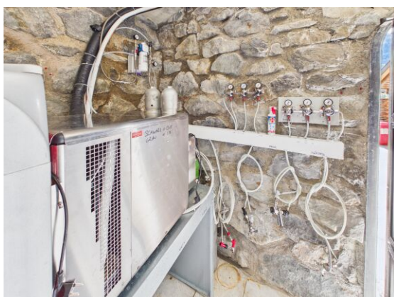
Zuleitungen Schankanlage (Felskeller).
