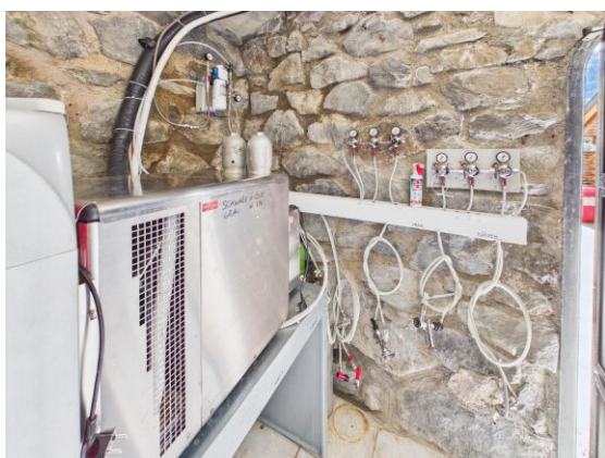
Zuleitungen Schankanlage (Felskeller).
